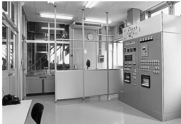
同 工場内 計器室
