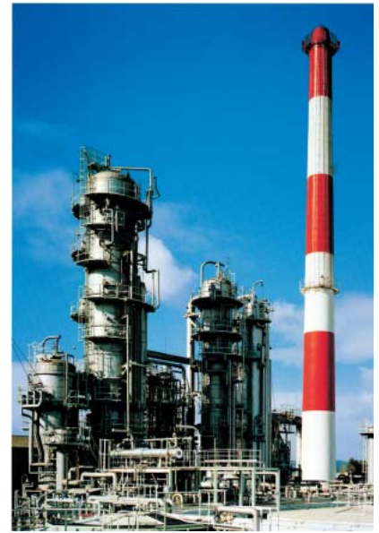
粗トール油の精留プラント
