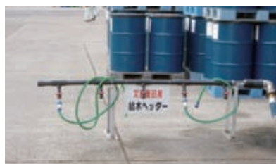
自家発電にてポンプを稼働し、地域住民への給水訓練を行いました。
