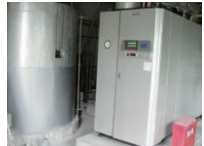
天然ガス蒸気ボイラー
