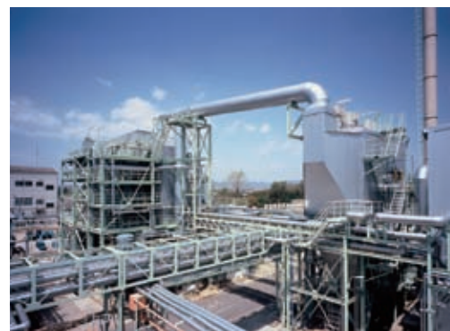
バイオマス発電設備
