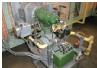
天然ガス用に交換した▶配管とバーナー設備
