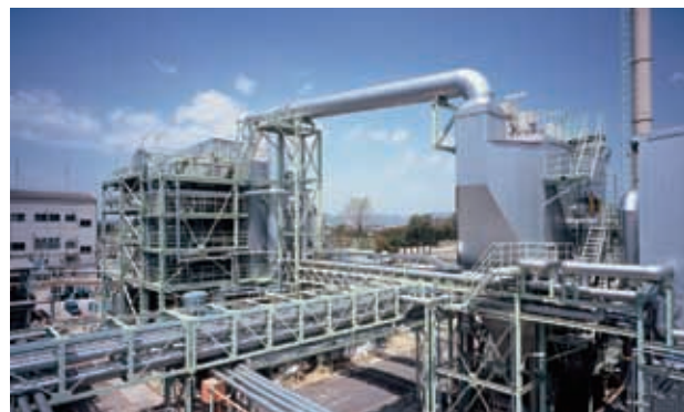
▲バイオマス発電設備
