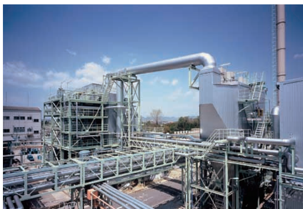
▲バイオマス発電設備
