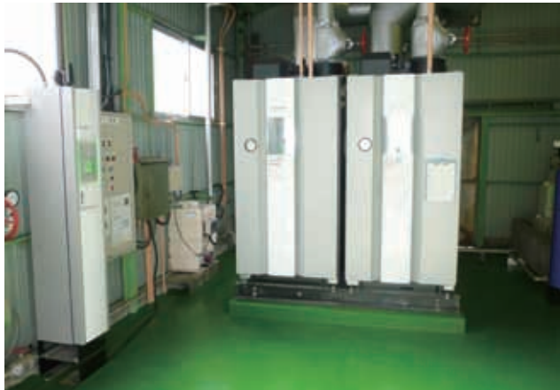
▲更新した四国工場のLPガス蒸気ボイラー
