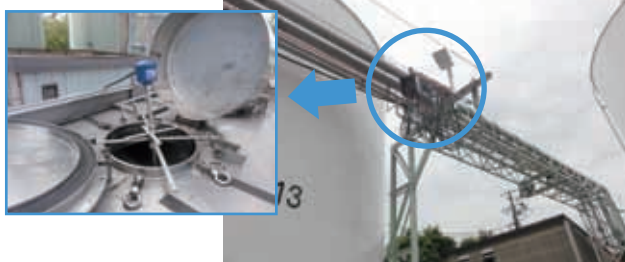
▲ローリー積み込み時の漏洩防止対策として、ローリー充填場にレベルセンサーを設置。
