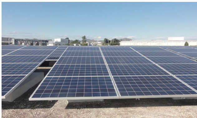
▲伊保港に保有する敷地に設置した太陽光パネル
