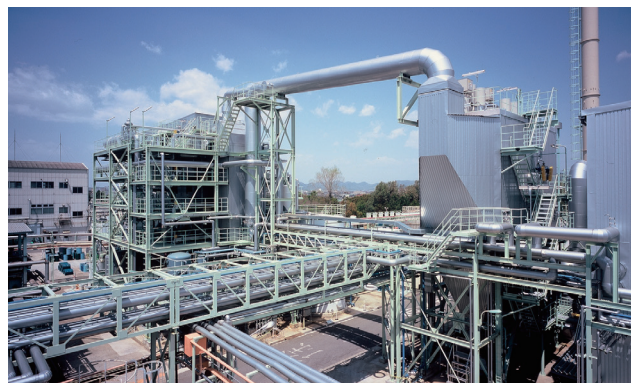
▲バイオマス発電設備
