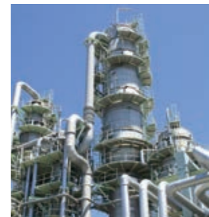
1958年に国内初トルール油精留プラントを完成し、1973年に世界初「完全クローズドシステム」トルール油精留プラント建設。現在も資源循環型事業の高度化を継続。
